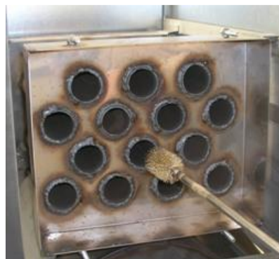
Tuburi de gaze de evacuare
